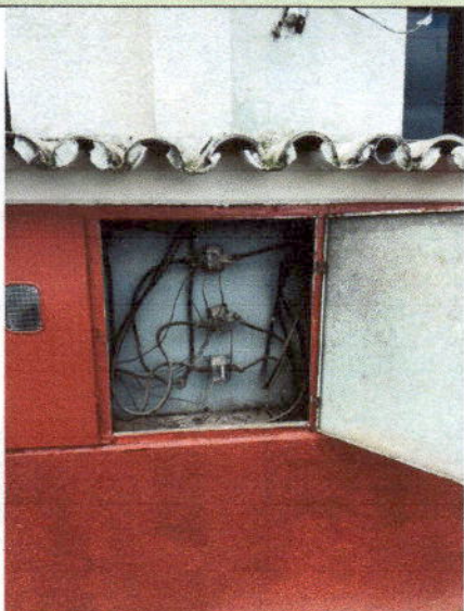
Vista dos quadros de distribuição de energia elétrica da edificação.
