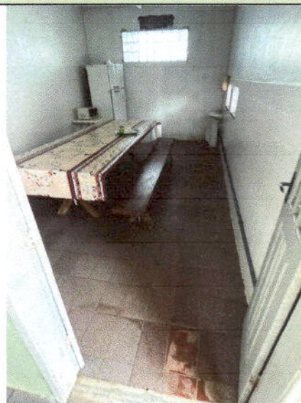
Vista do refeitório, registrando as condições existentes dos pisos e revestimentos.
