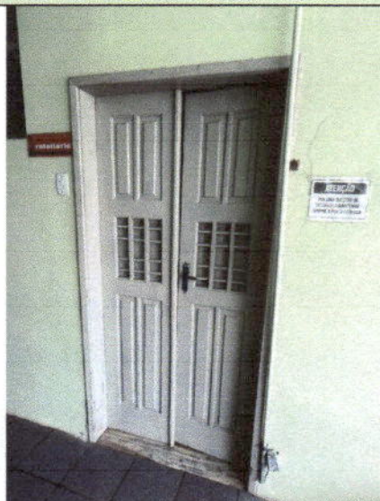
Vista da porta do refeitório, prevista para substituição durante a reforma.
