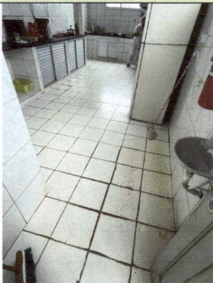
Vista complementar da cozinha, evidenciando o estado atual dos revestimentos.
