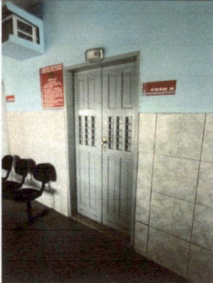
Vista da porta de consultório, prevista para substituição.
