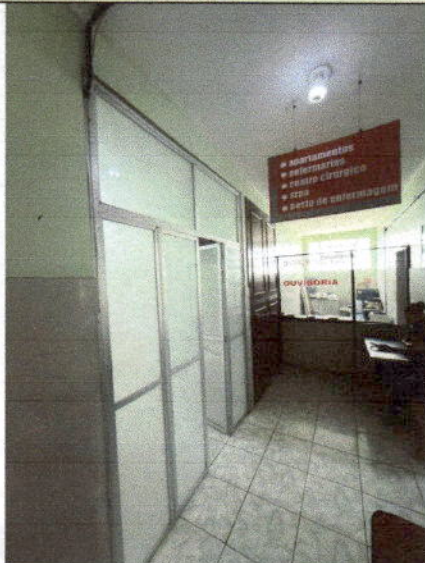
Vista do corredor interno, registrando as condições atuais dos pisos e revestimentos.
