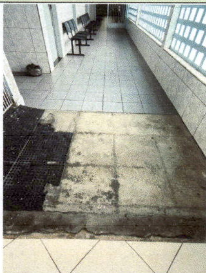
Vista de corredor interno, registrando o estado atual dos revestimentos de piso e parede.
