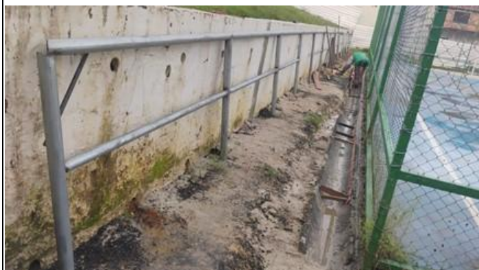
Vista da contenção com guarda-corpo confeccionado
