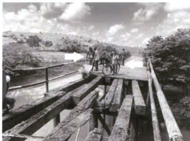
Figura 23 – Ponte danificada na Localidade da Mariquita.
